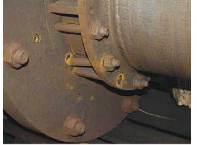
Fig. 10 Hydrogen embrittlement of a pump joint bolt / pompa bağlantı civatasının hidrojen gevremesi
